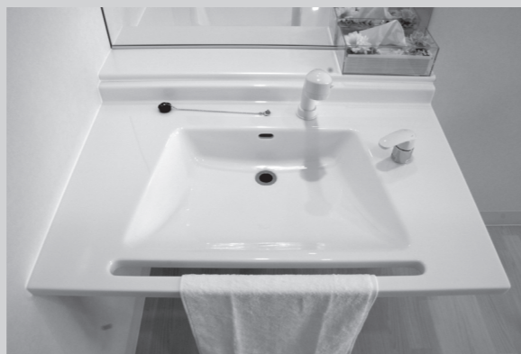
写真3 水栓を手前つけた洗面
